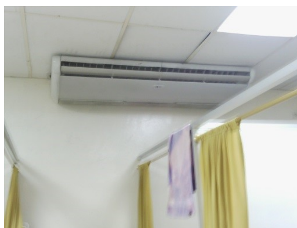
Figura 22: Acondicionador de aire dañado
