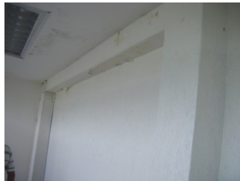
Figura 30: Manchas de humedad en Palco Presidencial
