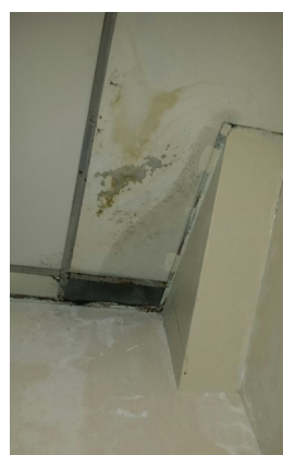
Figura 26: Mancha de humedad/ tumbado falso dañado
