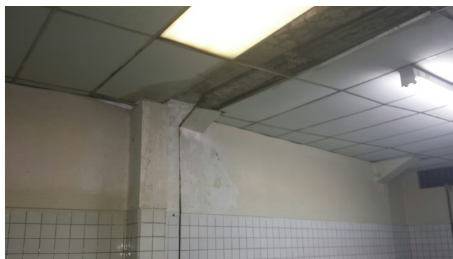
Figura 27: Vista General del daño
