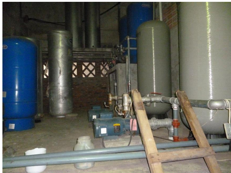
Figura 6: Cuarto de Bomba y cisterna Camerinos
