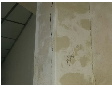
Figura 25: Columna fisurada / Mancha de humedad/
