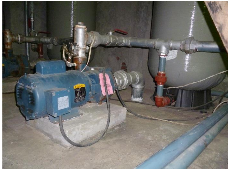
Figura 7: Bomba 3HP Camerinos
