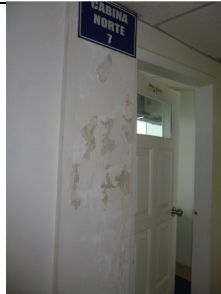
Figura 34: Recubrimiento de las cabinas norte con rastro de humedad
