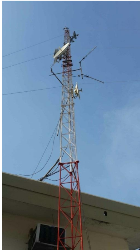
Figura 36. Torre 90 metros ubicada en San Carlos Fuente: Autor
