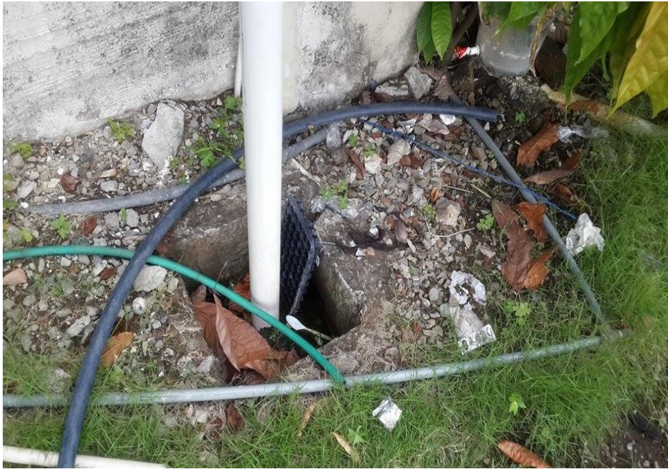
Figura 3.8 Punto de agua.
