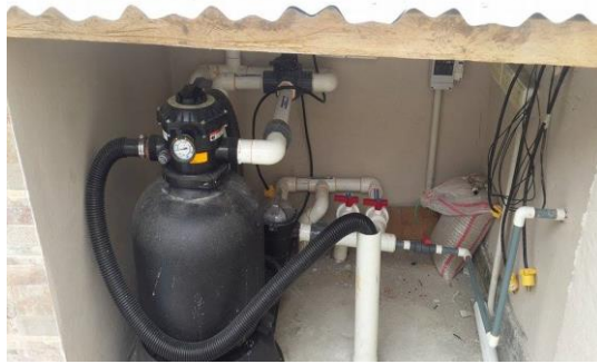
Figura 4.24 Cuarto de Equipos.
