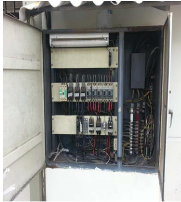
Figura 3.4 Tablero de distribución auxiliar.
