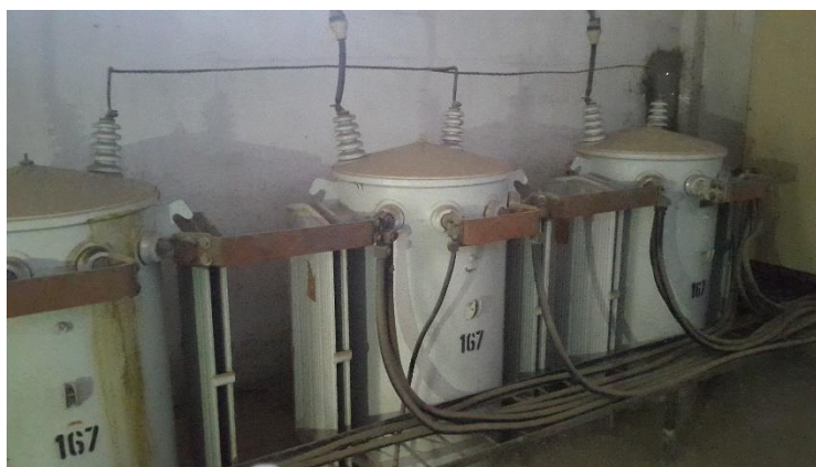
Fig.24 Banco de transformadores 501 KVA
