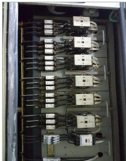
Fig. 29 Banco de Capacitores
