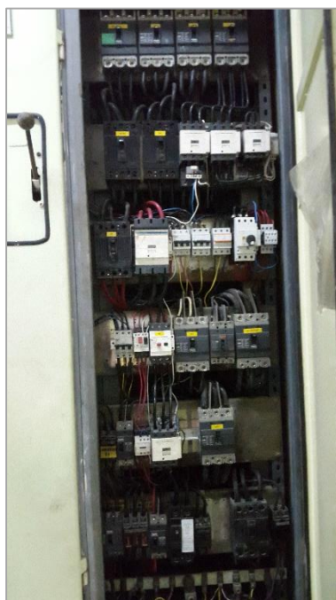
Fig. 27 Tablero de Distribución TDG
