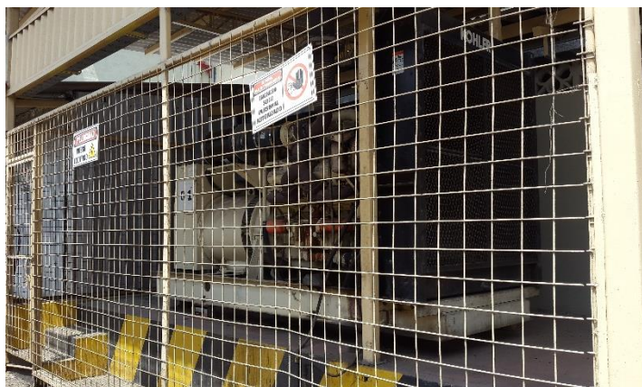
Fig.26 Generador de Emergencia Kohler
