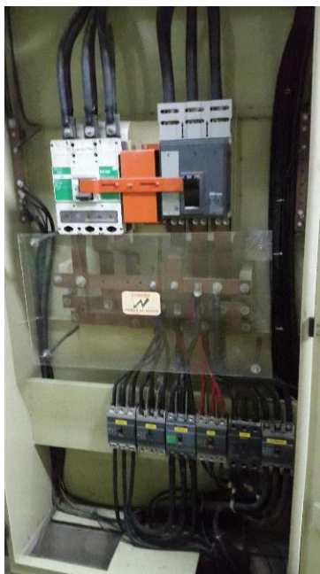
Fig. 28 Tablero de Distribución T.T.2
