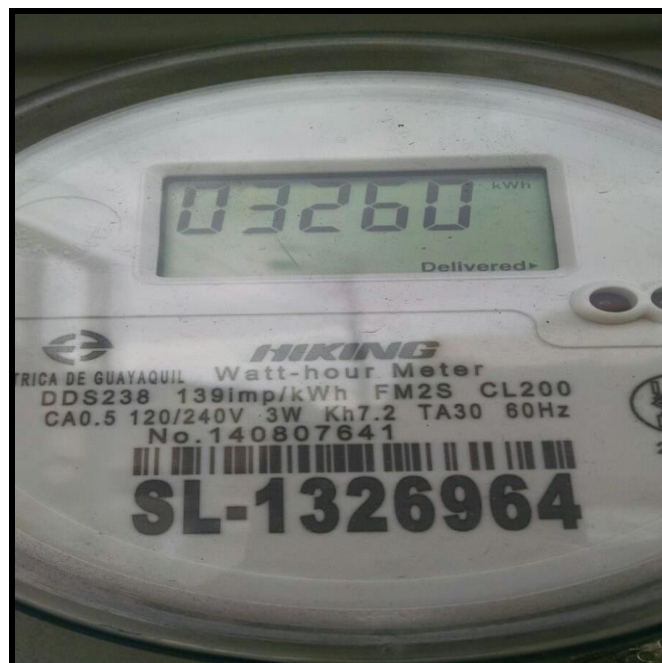
Figura 11. Medidor Monofásico de 220 Voltios Usado por CNEL Unidad de Negocio Guayaquil
