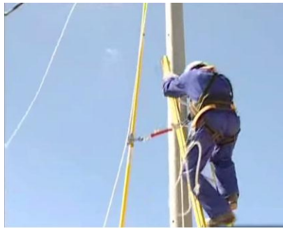
Figura 6.18 Equipos de protección
