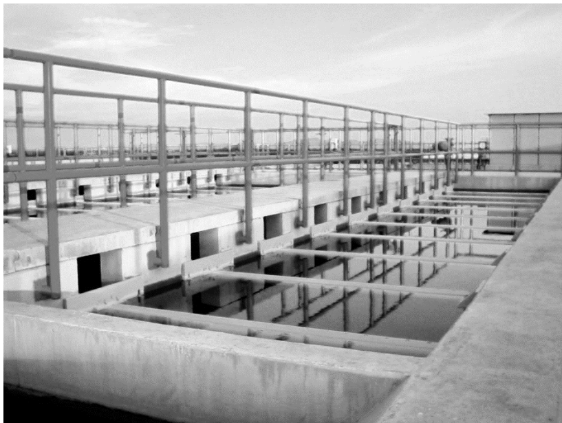
Planta de tratamientos Atahualpa, Santa Elena Fuente: (Salame, 2015)
