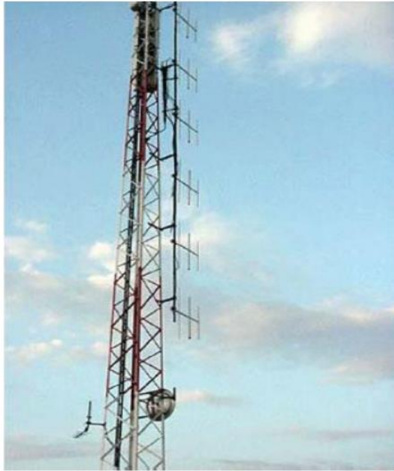
Figura 2. 14: Sistema radiante (Array de antenas)
