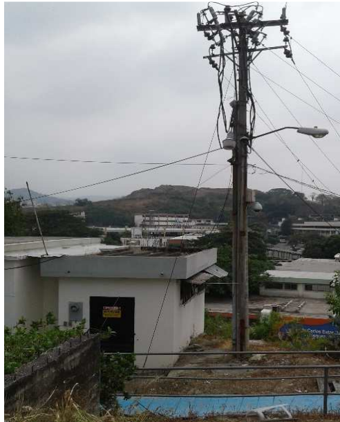
Fig. 3. 3 Ubicación fotográfica del Banco de transformadores.
