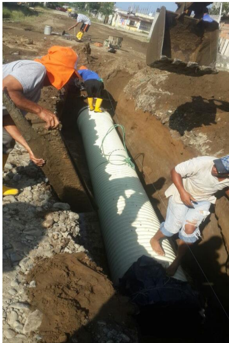
Tubería Ø1150 mm.
