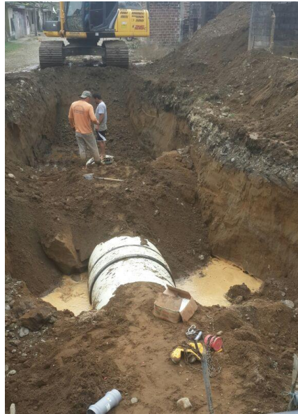
Figura 14: Colector principal \varnothing 1345mm Fotografía captada: Marlon Leones (2016)
