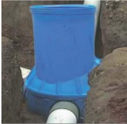
Figura 16: Cámara de inspección
