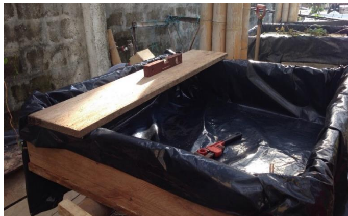
Figura 4.1: Instalación del cajón automatizado dentro del huerto hidropónico Fuente: Elaboración propia
