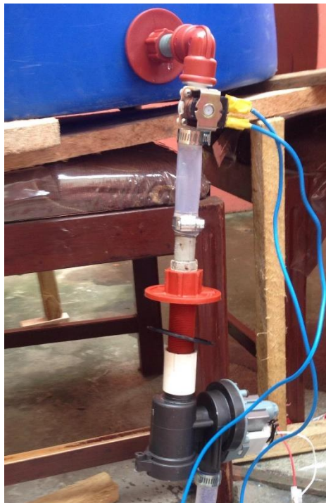
Figura 3. 25: Prueba de funcionamiento de la electroválvula Fuente: Elaboración propia
