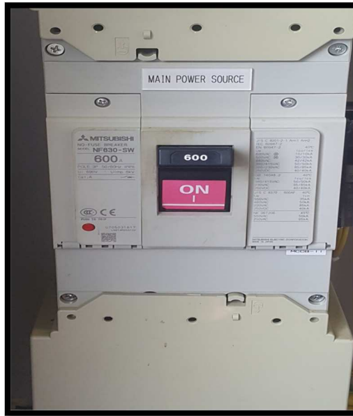
Figura 4. 1: Disyuntor de 600 A Fuente: EMRAPAH
