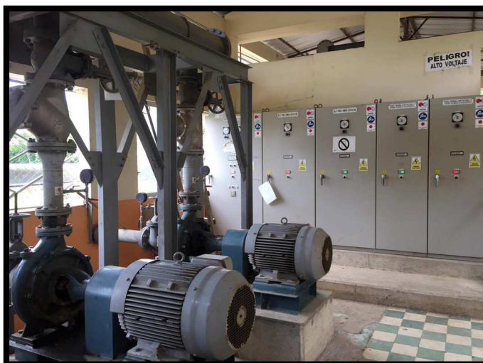
Figura 3. 3 : Paneles y Bombas Fuente: EMRAPAH
