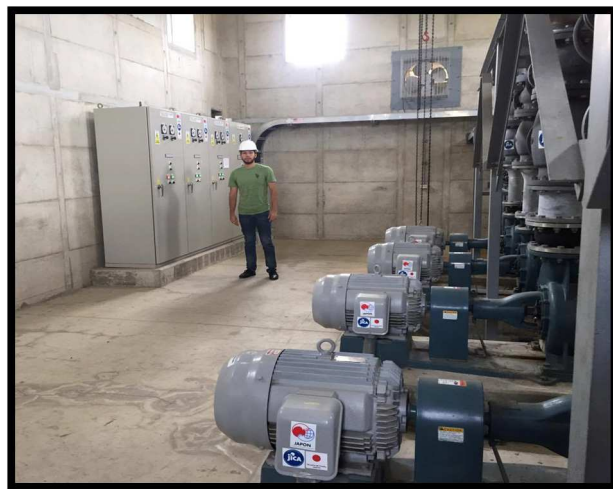
Figura 3.5 : Sistema de bombas planta nueva Fuente: EMRAPAH
