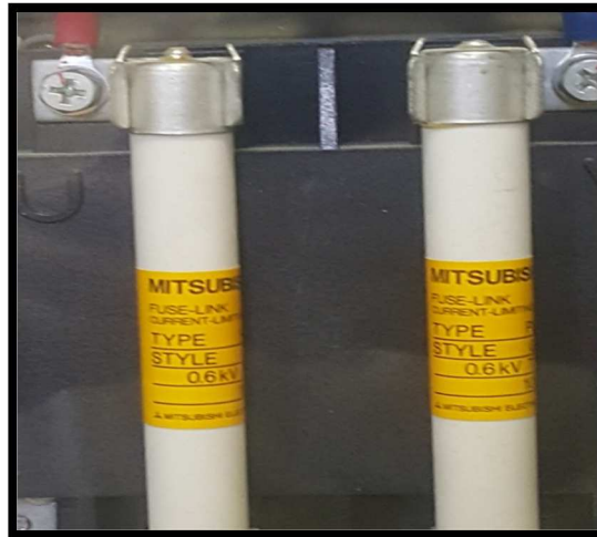
Figura 4. 12: Fusible de 0.6 Kv Fuente: EMRAPAH
