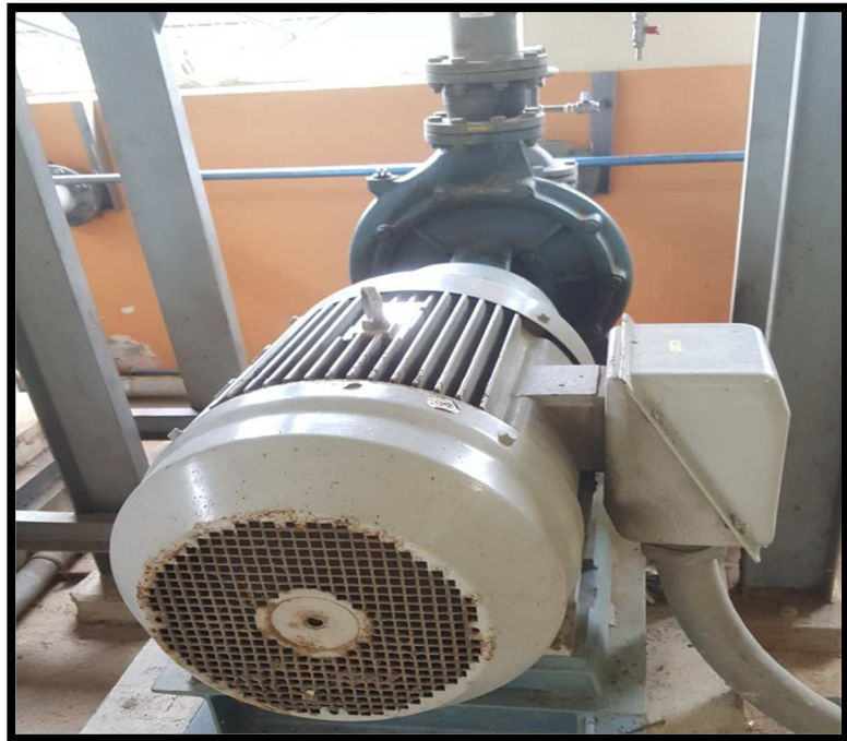
Figura 4. 31: Bombas 1 – 2 – 3 Fuente: EMRAPAH
