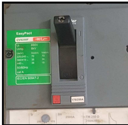
Figura 4. 13: Disyuntor de 250 A Fuente: EMRAPAH
