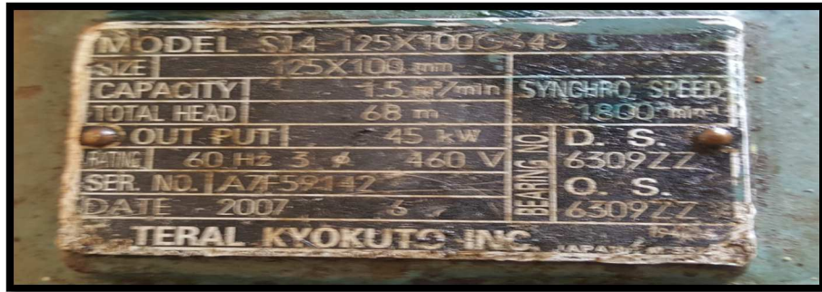
Figura 4. 30: Placa de Turbina de Bombas 1 – 2 - 3 Fuente: EMRAPAH
