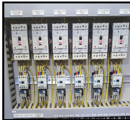
Figura 4. 26: Disyuntor de 15 A Fuente: EMRAPAH
