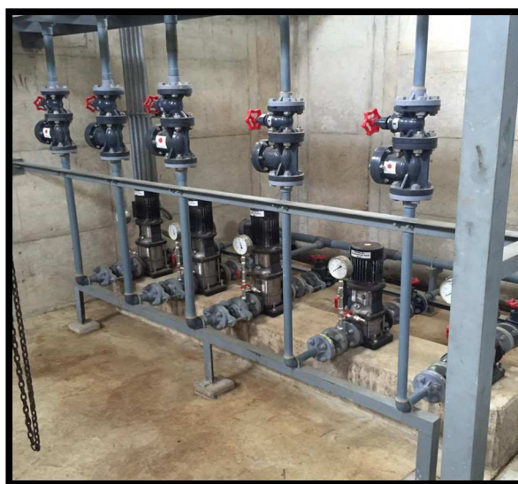
Figura 3. 4 : Sistema de Bombas de Agua de presión y suministro Fuente: EMRAPAH
