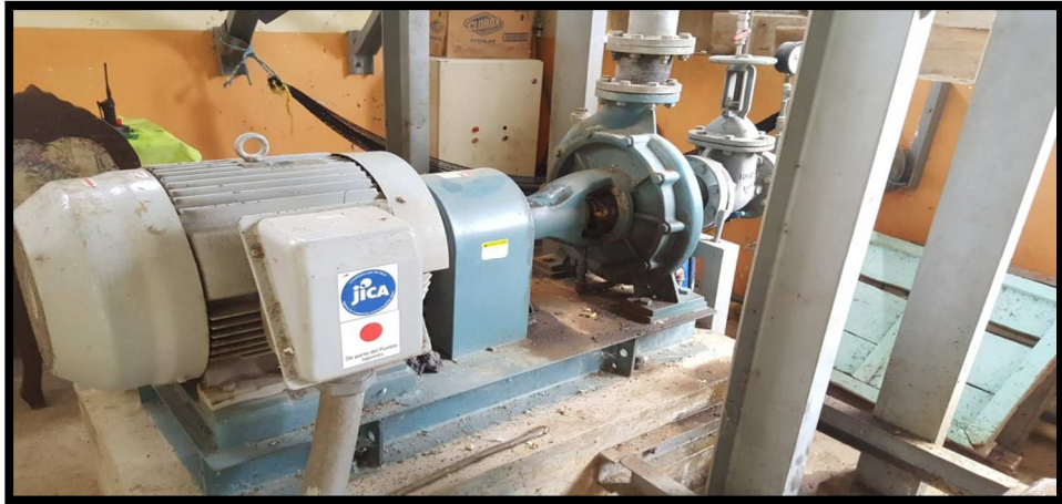
Figura 4. 33: Bombas 4 y 5 Fuente: EMRAPAH
