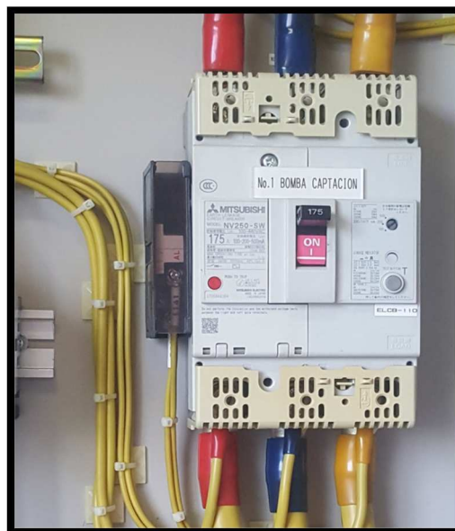
Figura 4. 2: Disyuntor de bomba de 175 A Fuente: EMRAPAH
