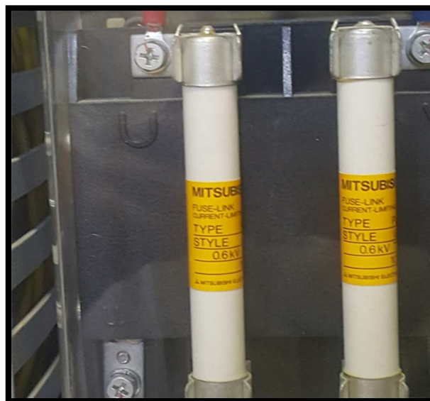
Figura 4. 22: Fusible de 0.6 Kv Fuente: EMRAPAH
