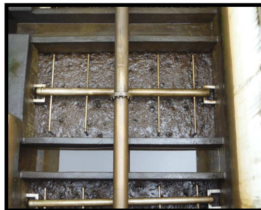
Figura 3. 8 : Área de Filtros Rápidos Fuente: EMRAPAH
