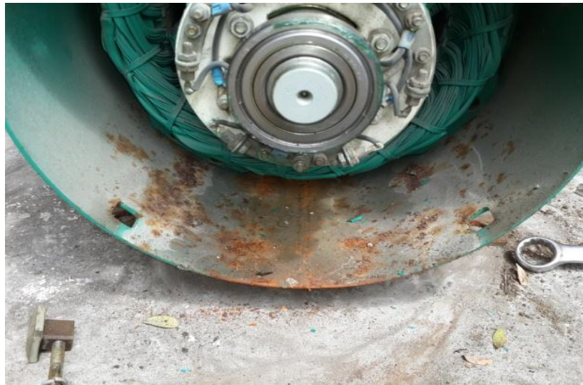
Figura 3.16 Estator con muestras de oxidación El autor 2016
