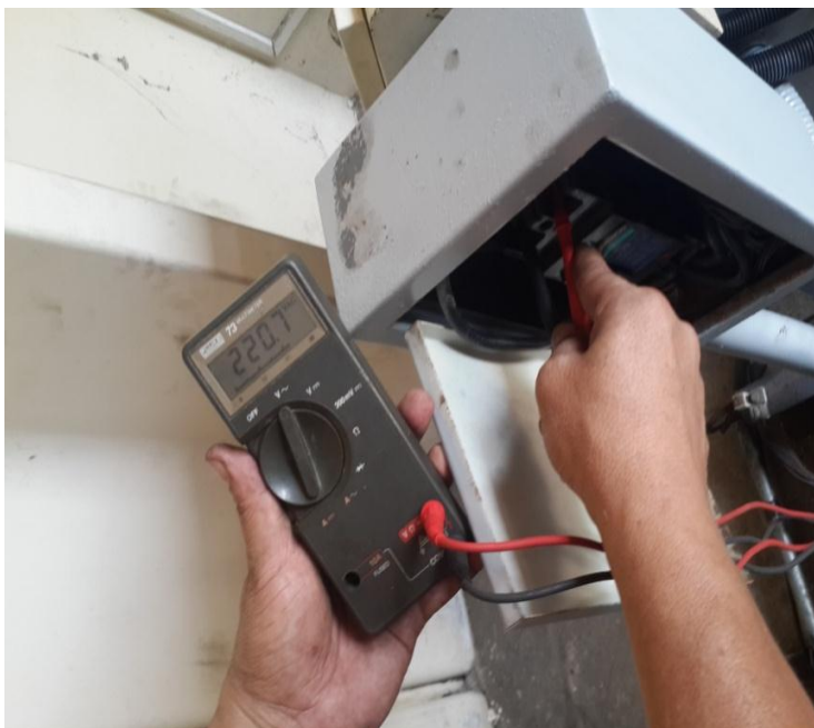
Figura 3.28 Medición de voltaje El autor 2016
