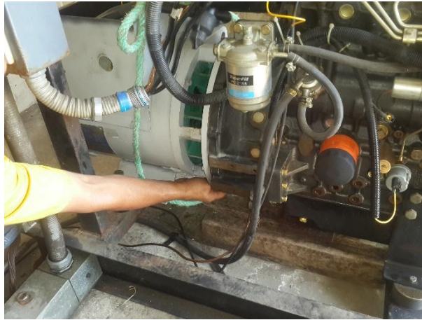
Figura 3.8 Separación de parte mecánica y eléctrica del generador El autor 2016
