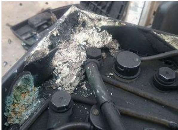
Figura 3.3 Borne de batería sulfatado Fuente: El autor 2016
