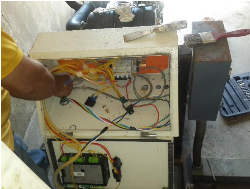
Figura 3.7 Desconexión de cableado eléctrico El autor 2016
