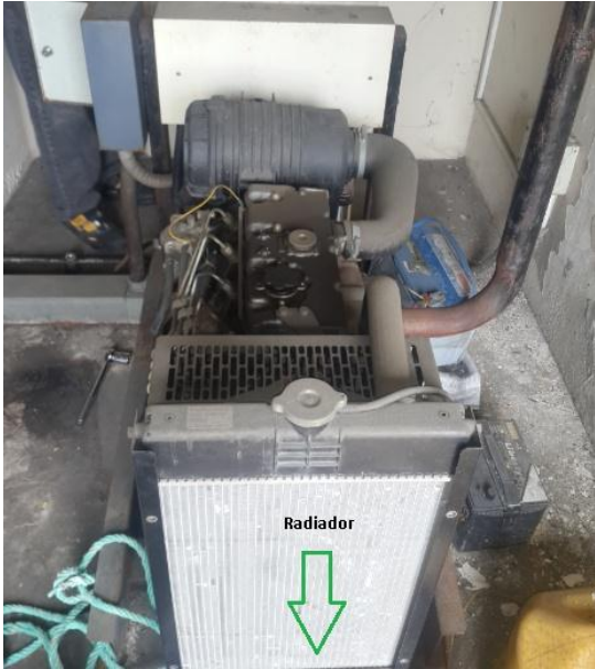
Figura 2.29 Enfriamiento del generador MAGNAPLUS Fuente: Marathón Electric Mfg. Corp. 2008
