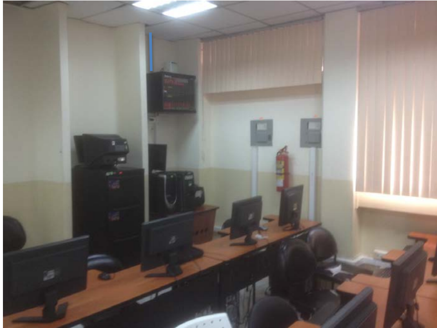
Figura 3. 16: Recorrido del cableado hacia el switch. Elaborado por: Autor
