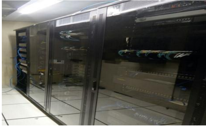
Figura 3. 3: Cuarto de equipos (rack, servidores) Fuente: Hospital, TICS
