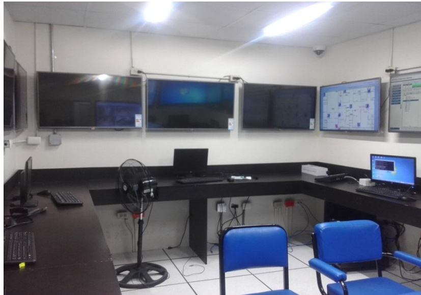
Figura 3. 7: Sala de monitoreo del data center Fuente: Hospital, departamento de TICS
