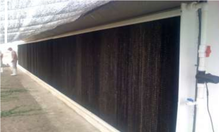
Paneles húmedos de control de humedad interna
