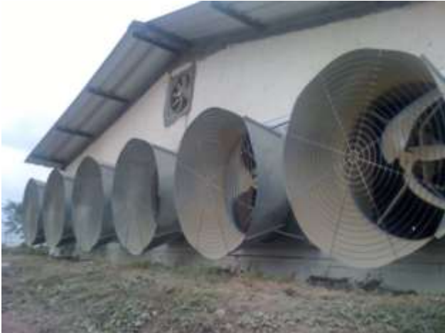
Extractores de aire para ventilación de galpones
